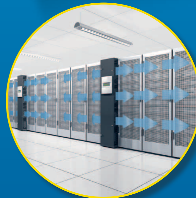
Kaltluftführung vor den Racks
